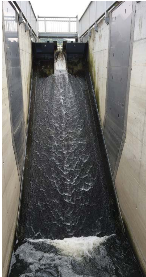
Abb. 4: Permanente Abstiegsmöglichkeit über das Modul des beweglichen Kraftwerkes LaKW
