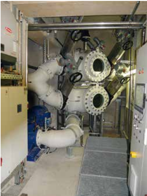
Abb. 3: Schleusenammern und Steuerungstechnik der Fischabstiegsanlage
